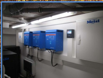
Wechselrichter 15kVA Li-Eisen-Phosphat Akkublock Speicherkapazität: 38,4kWh
