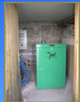
Pflanzöl- Blockheizkraftwerk (Rapsölbetrieb) 8kW Elektrisch 16kW Wärme
